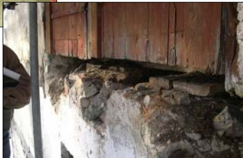
Skador i murverk och lucka, före åtgärder år 2005.
