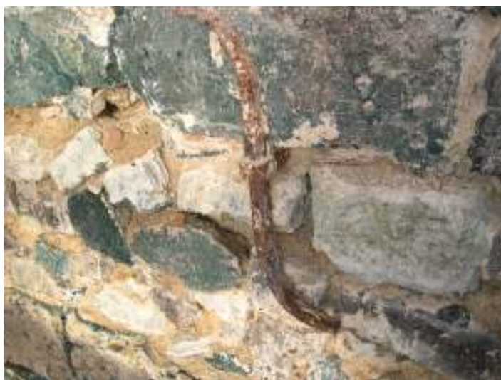
Murverket av slaggsten och slaggtegel samt ankarslut, före åtgärder år 2005.
