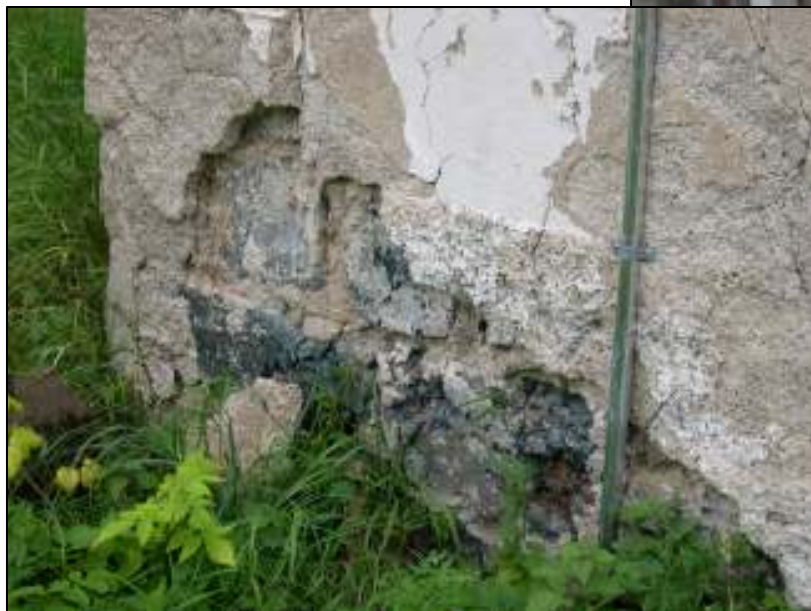
Skador på sockeln, före åtgärder år 2005.
