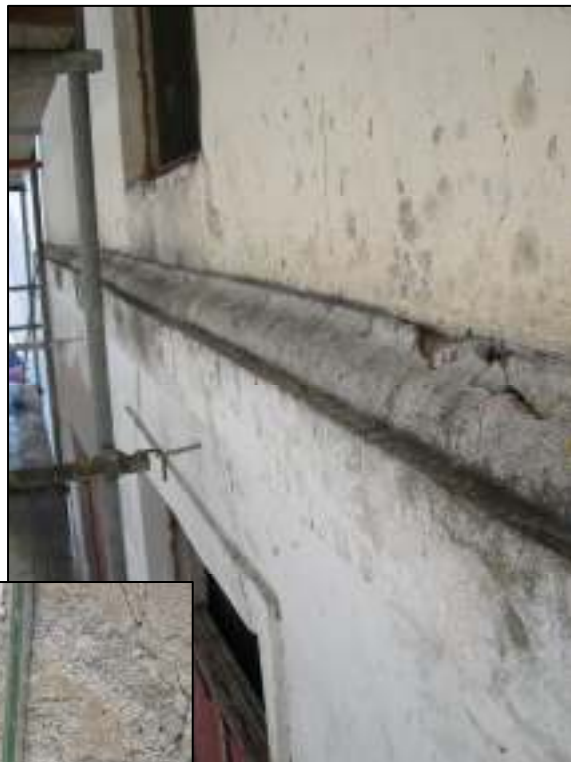
Skador i puts och gördelgesims, före åtgärder år 2005.
