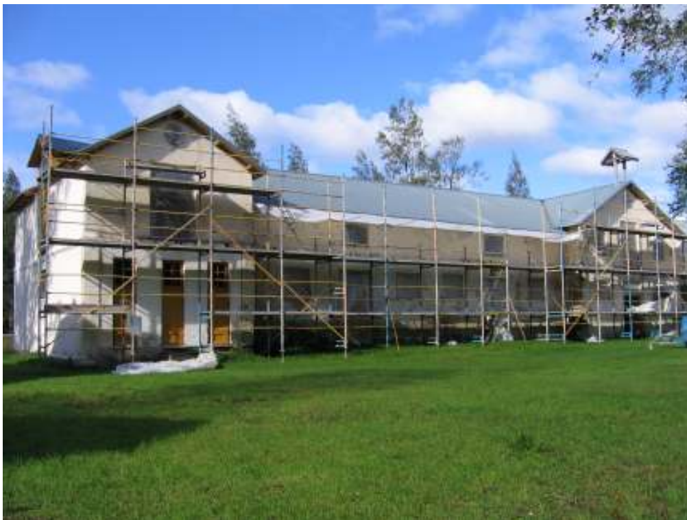
Västra och östra fasaden efter åtgärder, år 2006. Längs västra fasaden stod ställningarna uppe vid slutbesiktningen år 2006 och dörrarna var kvar att montera på plats.
